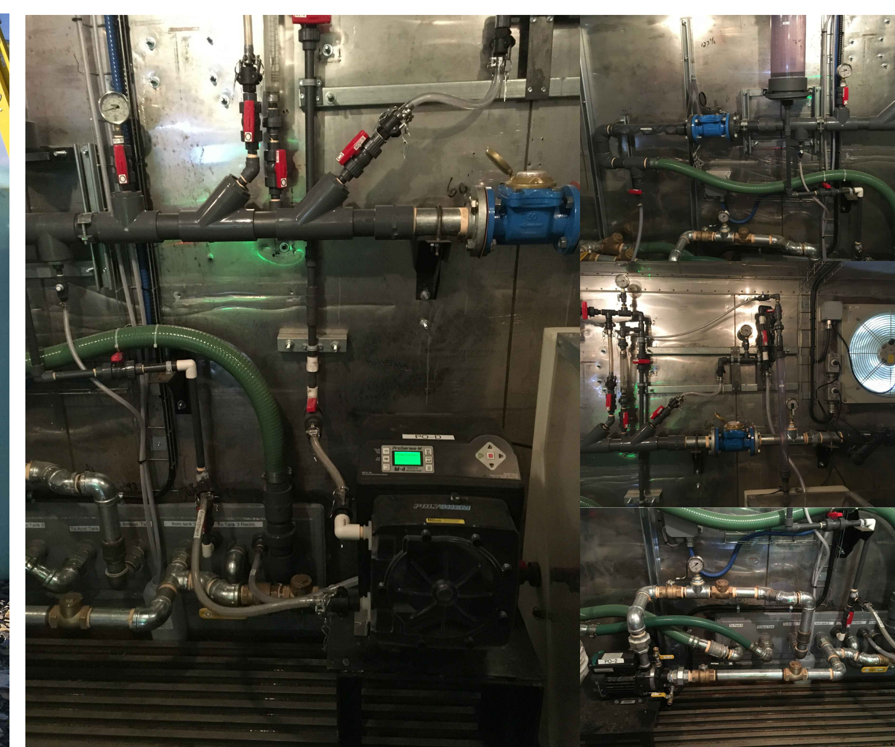
Figure 6-9: différents éléments de l'intérieur de l'unité de traitement.
