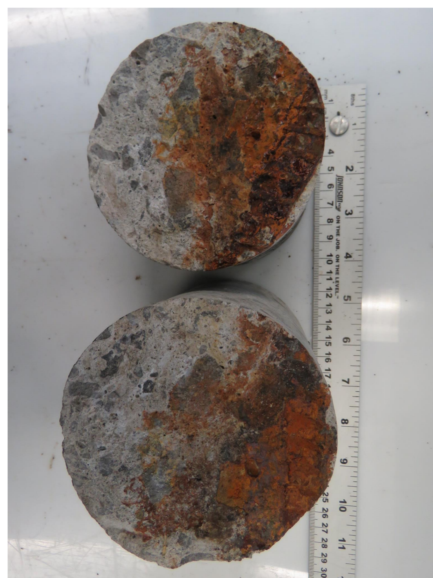
Figure 3 : Importantes traces de corrosion autour d'une armature d'acier, MTMDET, QC.
